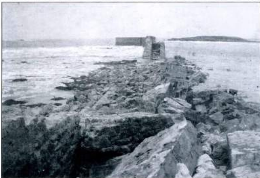
Sur cette carte photo, les dégâts sont plus évidents. Le problème de base étant le même dans bien des cas, notamment, celui de l'étanchéité des joints de maçonnerie.
